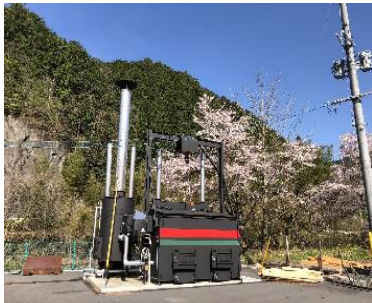
バイオマスボイラー
