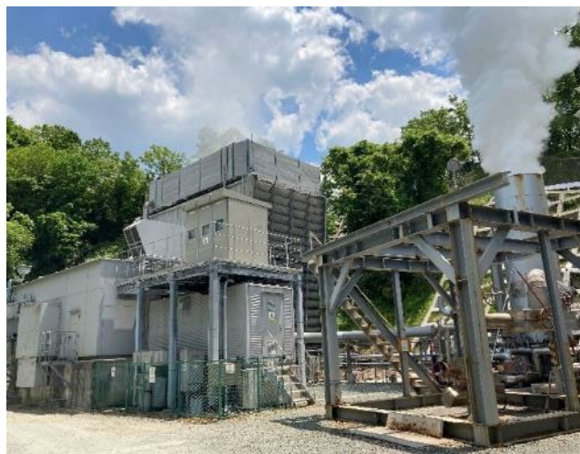
隣地にて稼働中の地熱発電所1号機
