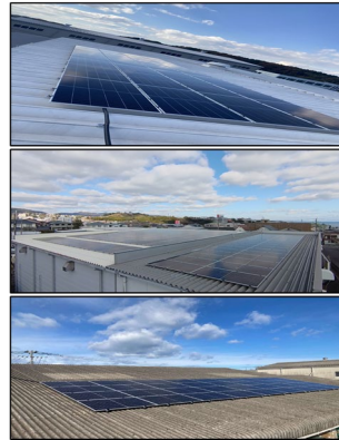
おおいたグリーン事業者に導入された太陽光発電設備
