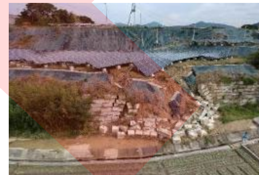
法面保護工が崩れて流出した事例
