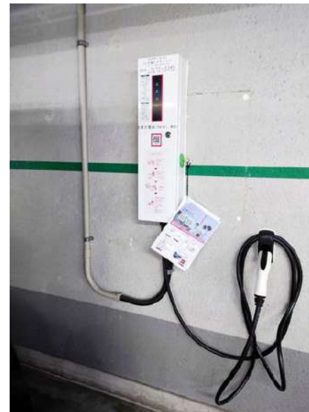
【設置機種】 普通充電器 6kW出力
