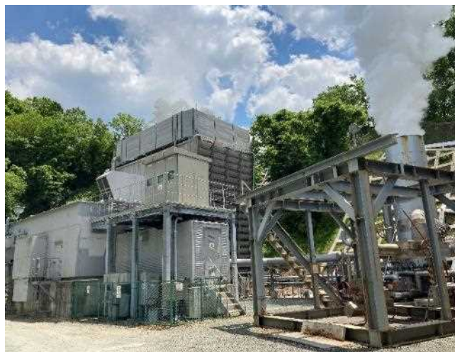
隣地にて稼働中の地熱発電所1号機
