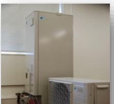
ヒートポンプ 給湯機
