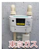
スマート ガスメーター
