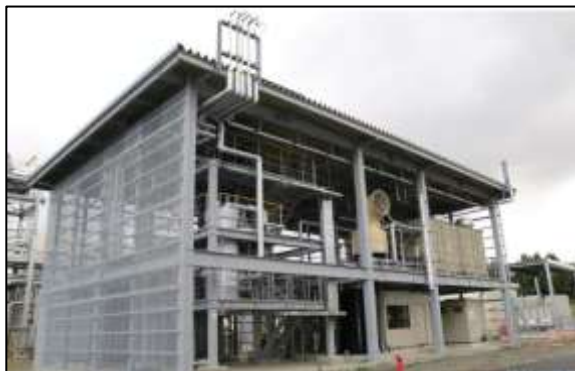
新潟県長岡市 越路原プラント内の実証設備
